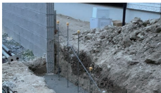
基礎の上に直接ブロックが積み重ねられている
